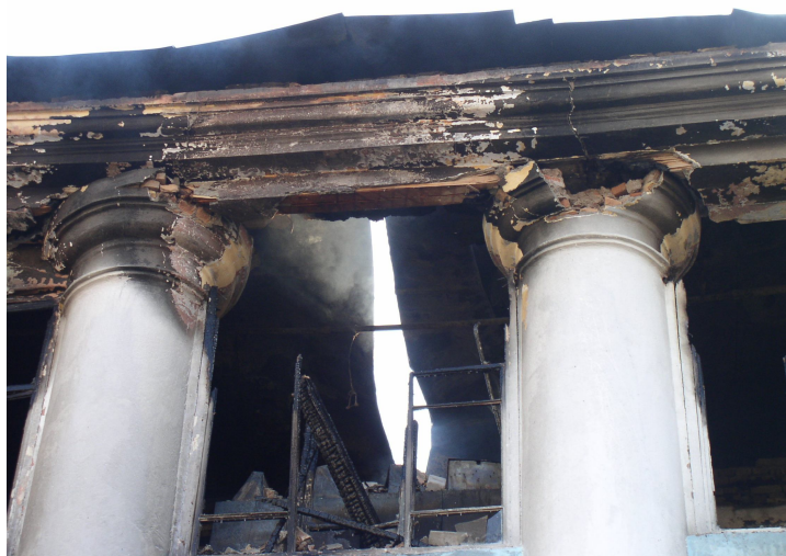
Рис. 2. Разрушение кирпичной кладки оголовка колонны.
