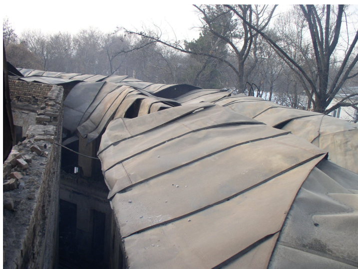
Рис. 8. Деформированные металлические листы кровли.
