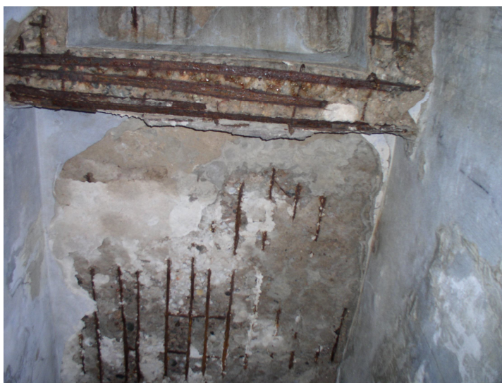
Рис. 3. Отслоение штукатурного слоя, оголение и коррозия арматурных стержней плиты перекрытия
