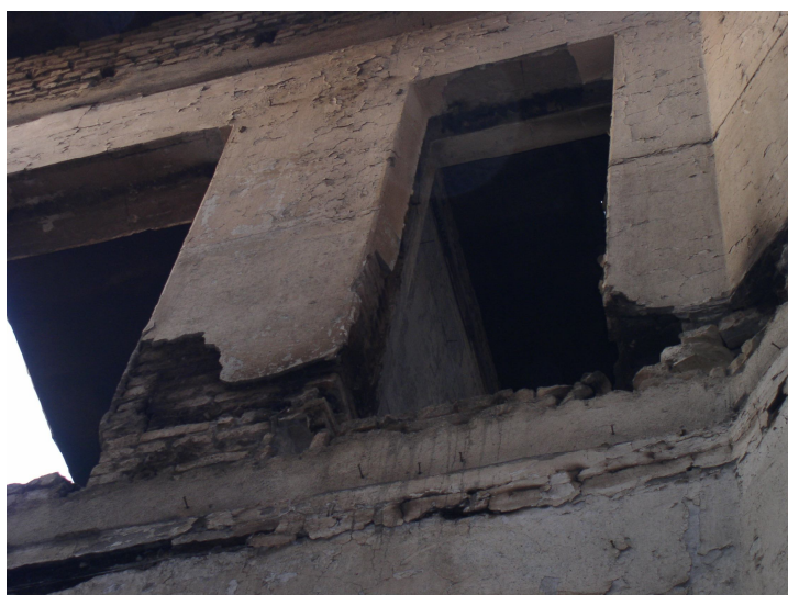
Рис. 7. Разрушение кирпичной кладки стены.
