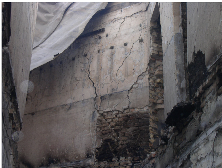
Рис. 6. Наклонные сквозные трещины шириной раскрытия до 4 см в стене 3-го этажа.
