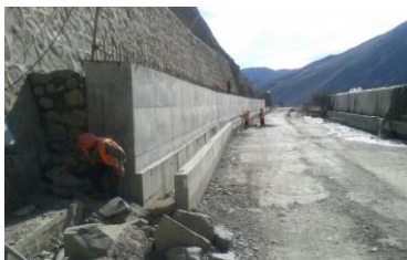
Рис. 4. Железобетонная стенка противолавинной галереи
