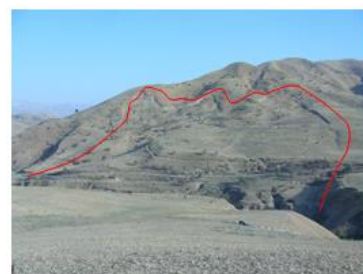
Рис. 5 Оползневой склон на ПК16 км с южного подхода
