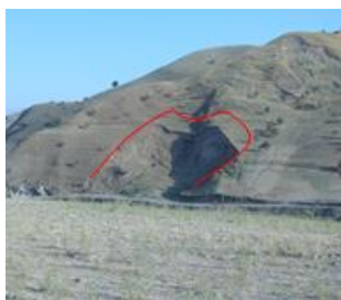
Рис. 4 Реализовавшийся локальный оползень ниже трассы проектируемой железной дороги на ПК16 с южного подхода
