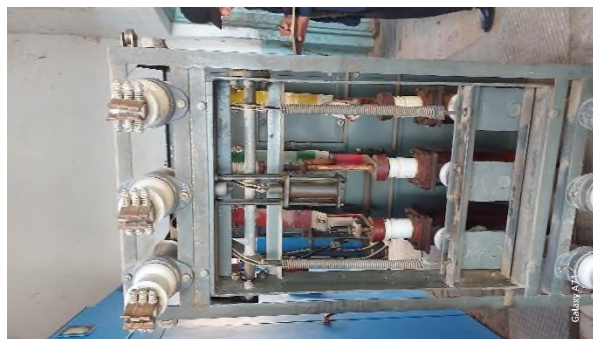
Рисунок 5 – б) внешний вид масляного выключателя 6кВ
