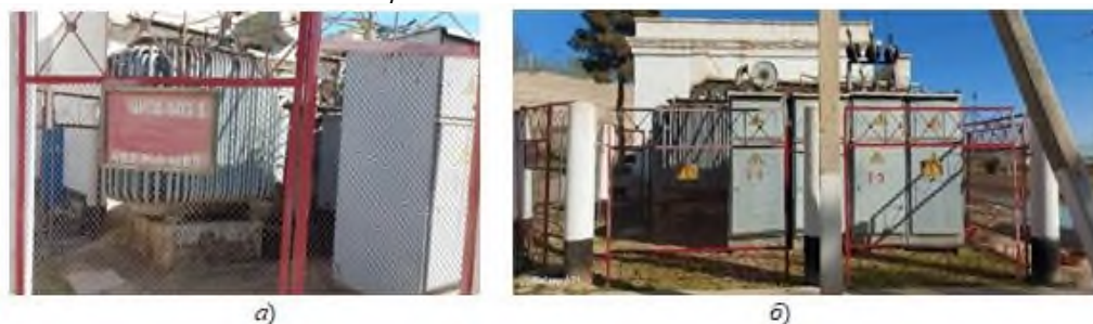
Рисунок 3 – Распределительный пункт 10/6/0,4кВ насосной станции Уртабуз-1 а)-общий вид трансформатора ТМ-1600/10-0,4 б)-ячейка РУ 6кВ насосной станции
