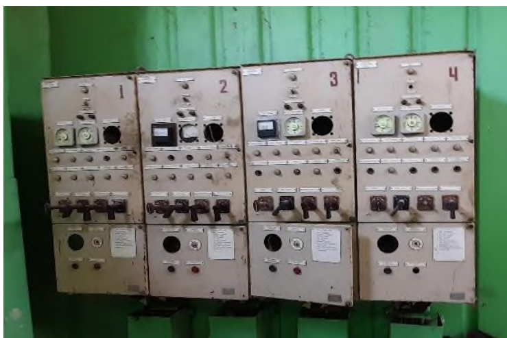
Рисунок 8– Пульт управления синхронных двигателей насосной станции Тошробод 2
