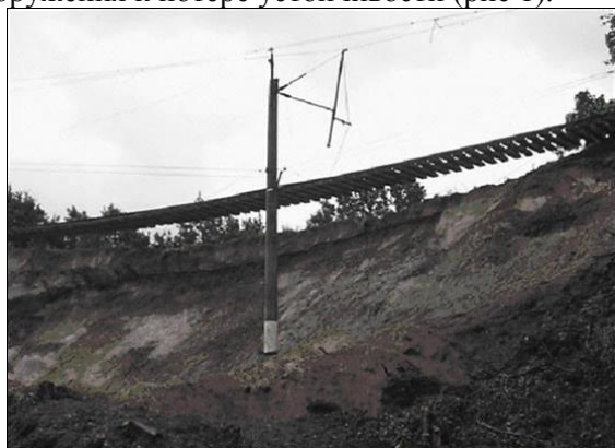
Рис.1 Обрушения откоса железнодорожного полотна в результате землетрясения.
