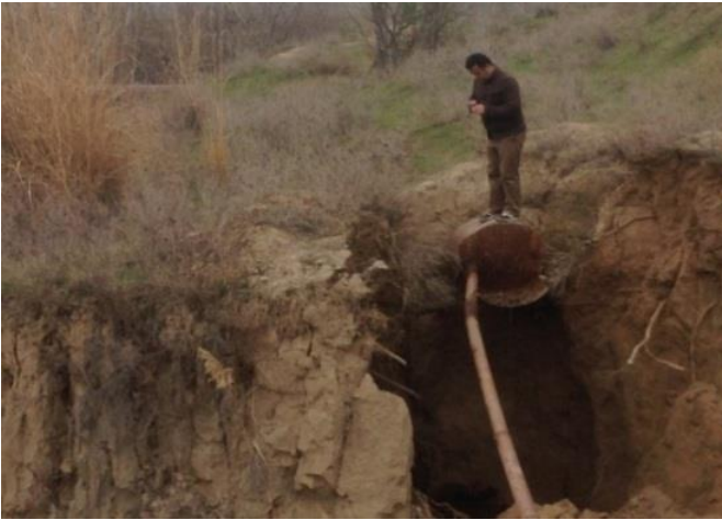
Рис. 3. Нецивилизованный (неправильно организованный) сброс излишков воды до местного базиса эрозии. В месте сброса виден сформированный псевдокарстовый колодезь глубиной 4,5 м (фото А.М. Кабирова)
