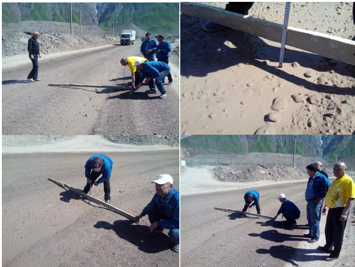
Рис 3. Неровности автомобильной дороги.
