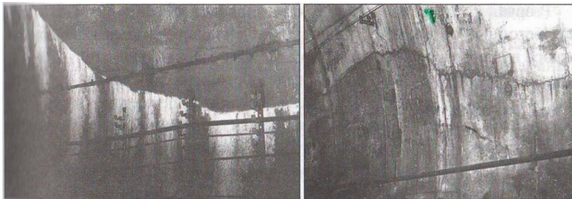
Рис. 2. Наклонные трещины в бетонной обделке раскрытием 5—6 мм с интенсивными высолами
