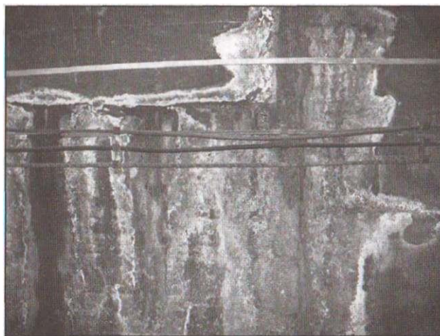
Рис. 3. Разрушение поверхностного слоя обделки в результате выщелачивания бетона
