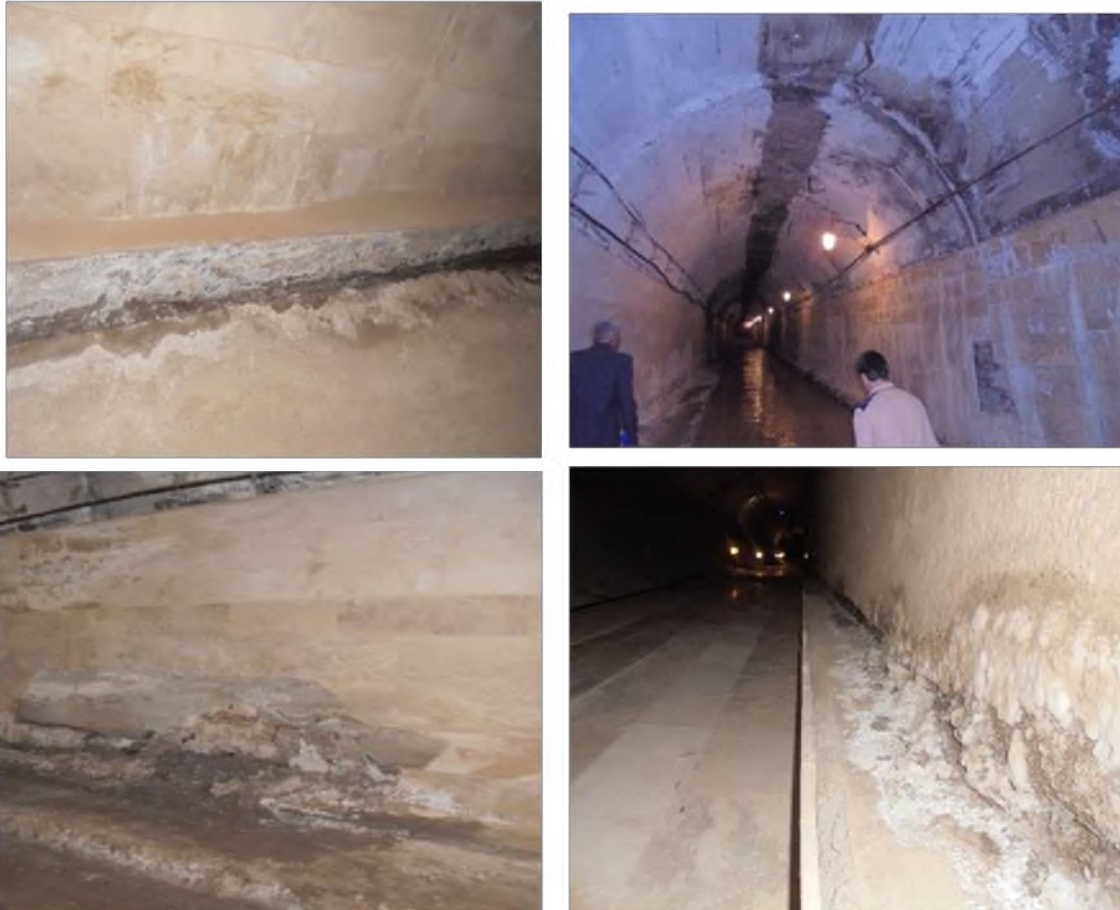
Расми 4 - Вайроншавии сатҳи бетонҳо дар қисматҳои девор ва сақфи нақби №3.
